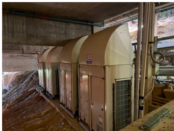
ระบบปรับอากาศภายในอาคาร X-29
