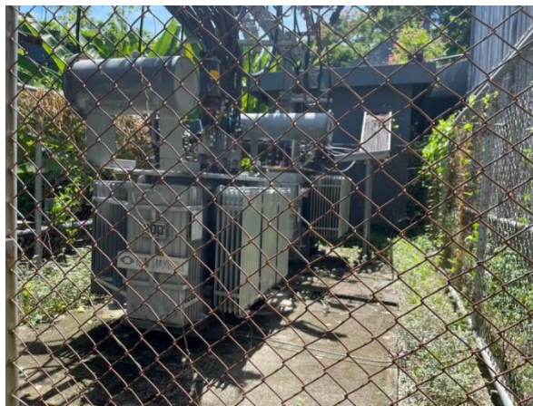
สภาพหม้อแปลงไฟฟ้า
