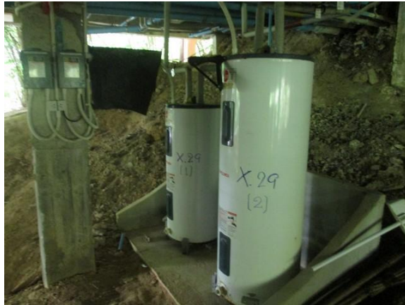
สภาพเครื่องกำเนิดน้ำร้อน (Boiler) ภายในอาคาร X-29
