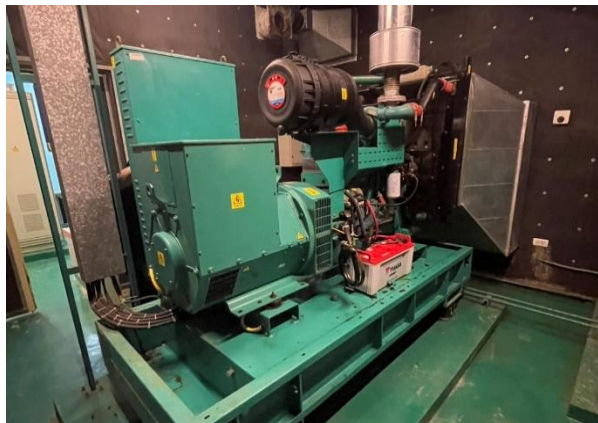
สภาพเครื่องกำเนิดไฟฟ้าสำรอง (Generator)
