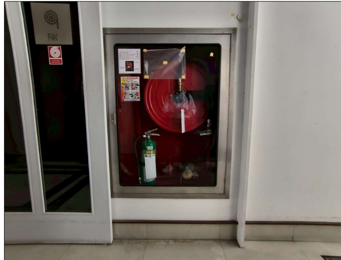
สายดับเพลิง (งานระบบในโครงการ)
