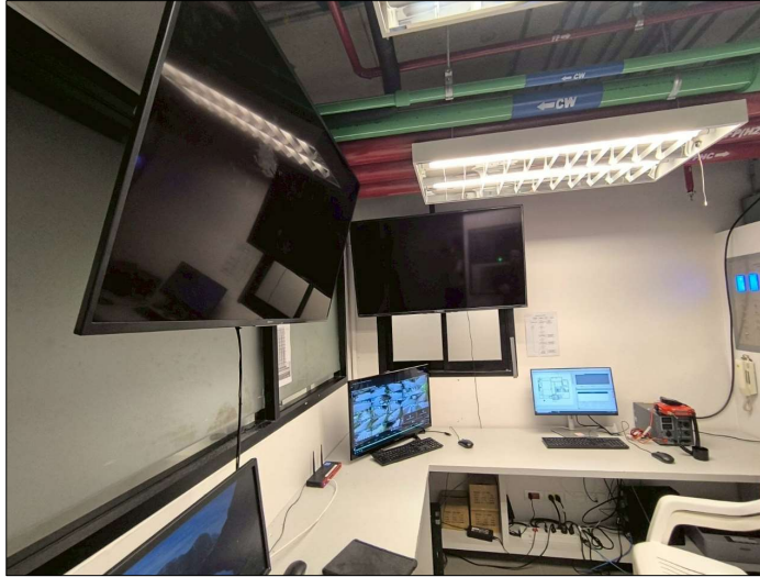
ระบบกล้องวงจรปิด CCTV (อยู่นอกเขตที่ดินทรัพย์สินที่ประเมิน แต่มีการเชื่อมต่อมาใช้งานระบบในโครงการ)
