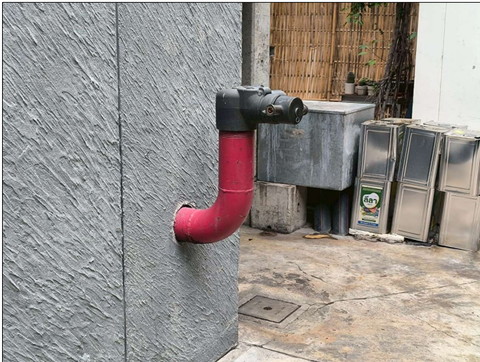
หัวรับน้ำดับเพลิง (งานระบบในโครงการ)
