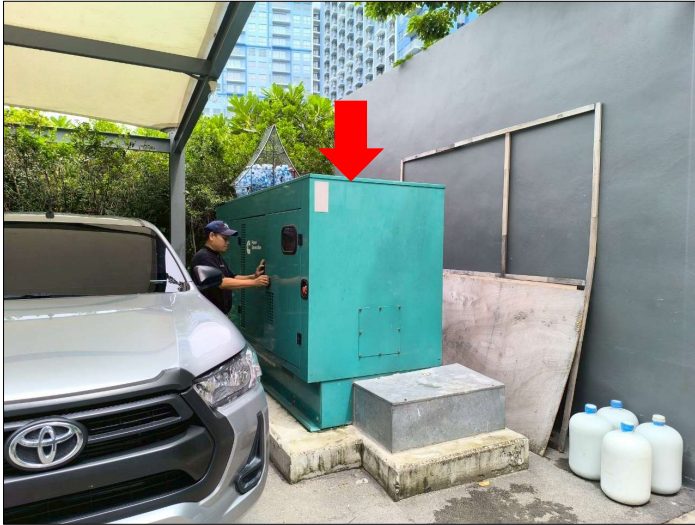
เครื่องปั่นไฟสำรอง Generator (อยู่นอกเขตที่ดินทรัพย์สินที่ประเมิน แต่มีการเชื่อมต่อมาใช้งานระบบในโครงการ)
