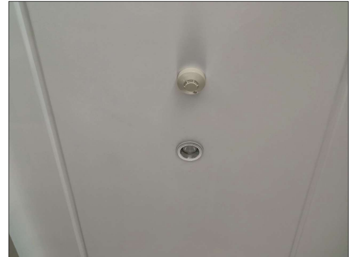
เครื่องตรวจจับควัน (งานระบบในโครงการ)
