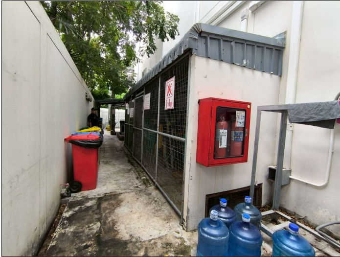
สถานีแก๊ส (งานระบบในโครงการ)
