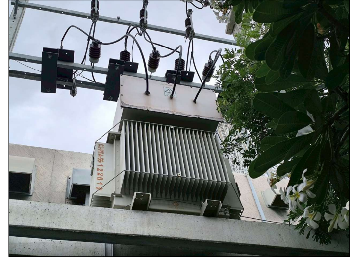
หม้อแปลงไฟฟ้า (งานระบบในโครงการ)
