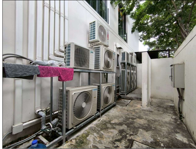
เครื่องปรับอากาศ (งานระบบในโครงการ)
